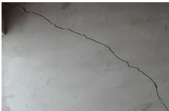
Figura 07 – Trinca 45° Fonte: Eng Responsável
