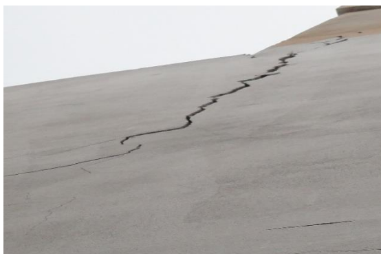
Figura 05 – Trinca na estrutura. Fonte: Eng Responsável.
