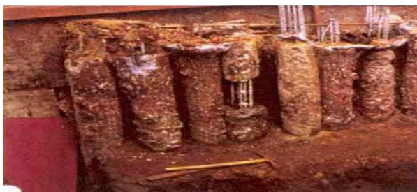
Figura 04 – Patologias em estacas escavadas. Fonte: Milititsy; Consoli; Schnaid, 2015.
