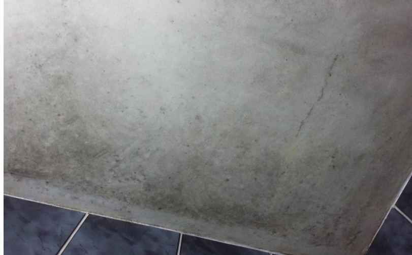
Foto 3: Umidade por condensação no teto de um banheiro Fonte: Autor
