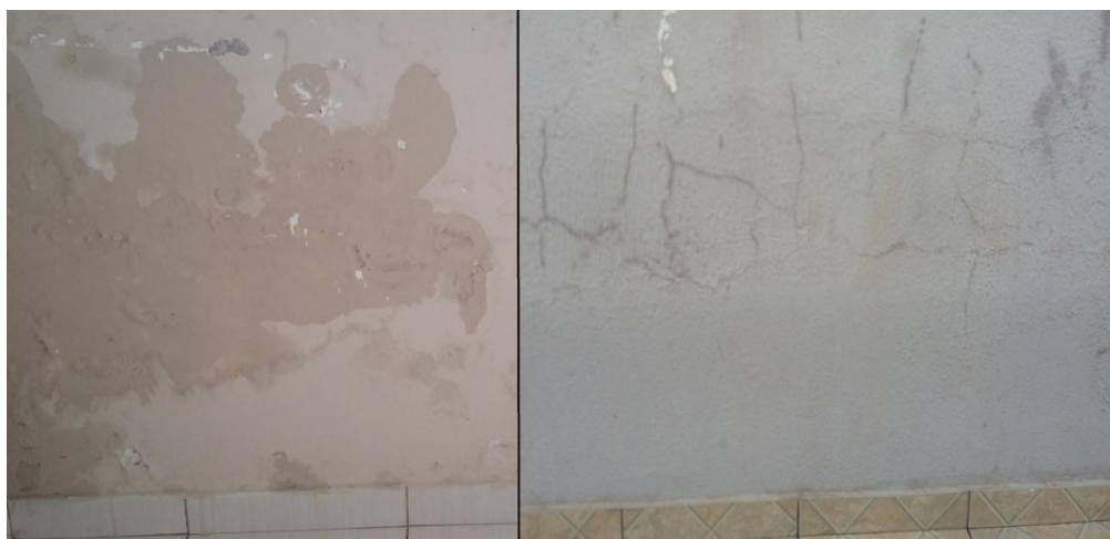
Foto 4: Interior e Exterior de uma parede com umidade por percolação Fonte: Autor
