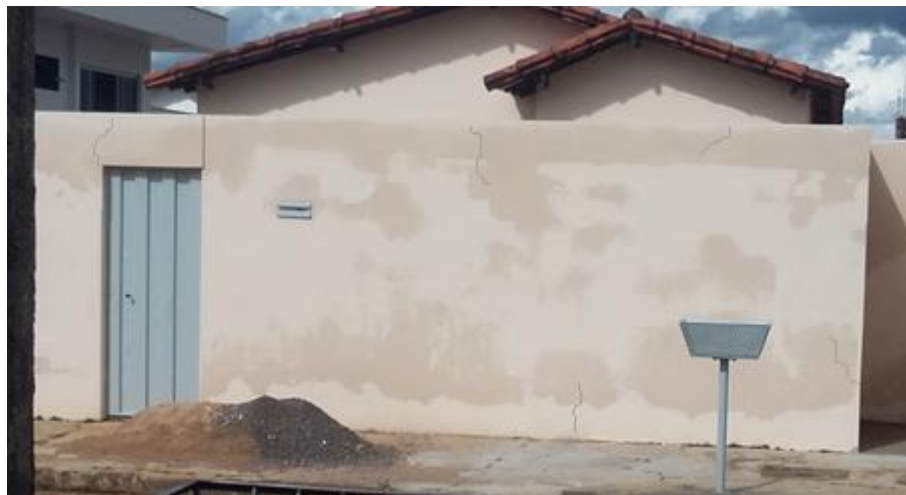
Foto 1: Umidade por Infiltração Fonte: Autor
